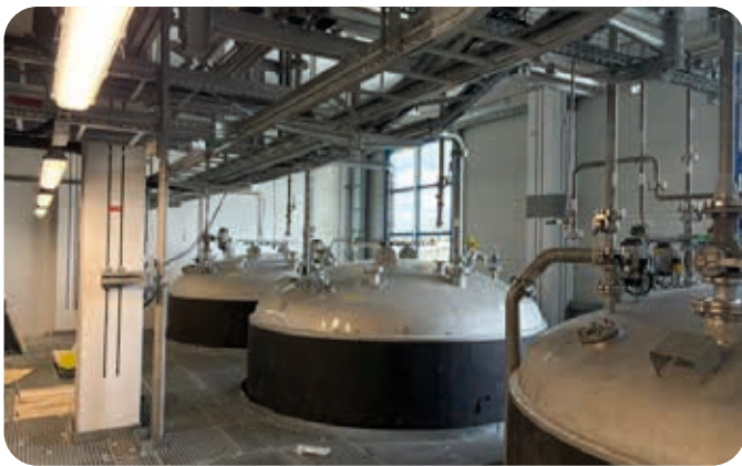
Blick auf die Mutterlaugenbehälter in der GUNI-2 Anlage
