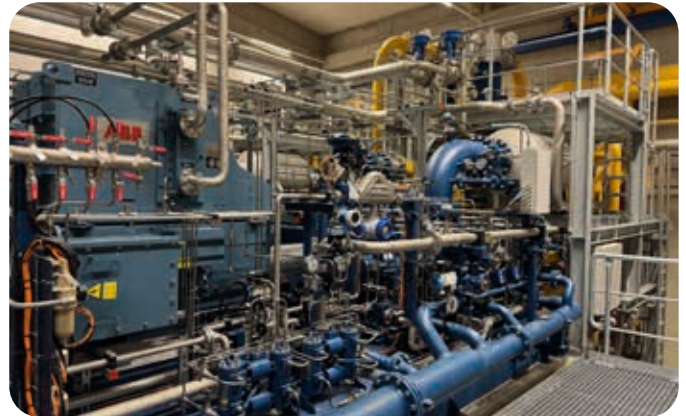
Der Kompressor fertig verrohrt und einschaltbereit
