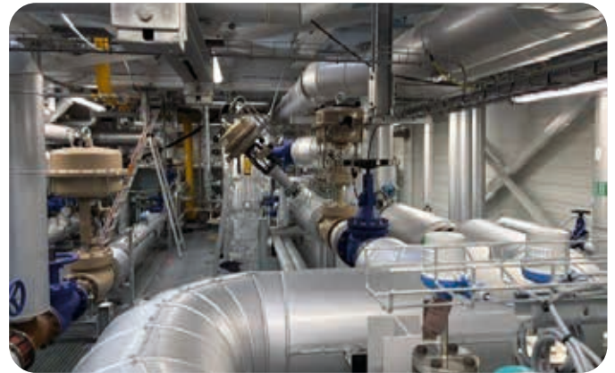
Fertige Installation im neuen Kesselhaus
